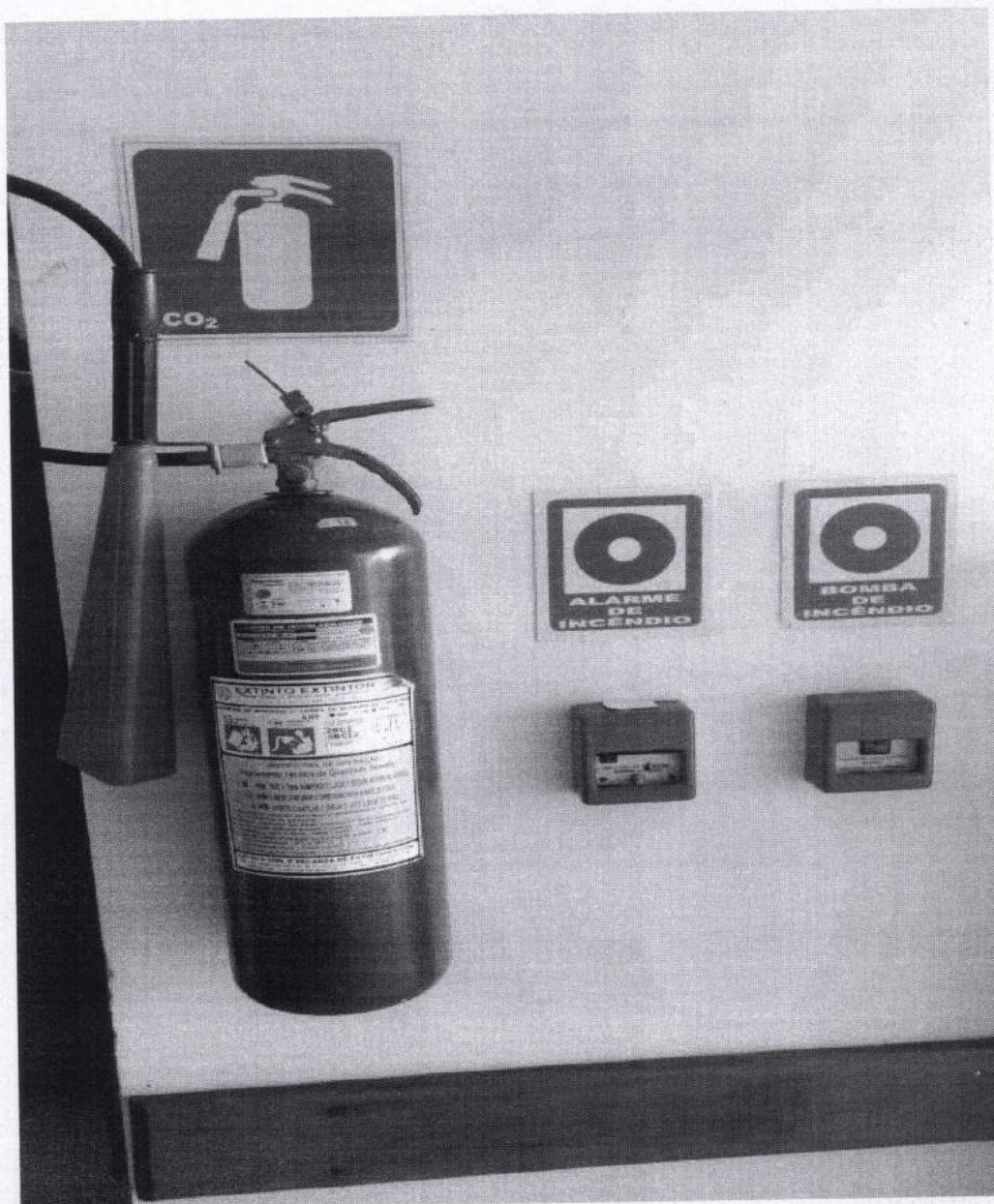
Extintor de incêndio próximo ao almoxarifado, conforme legislação pertinente a segurança do trabalho.
